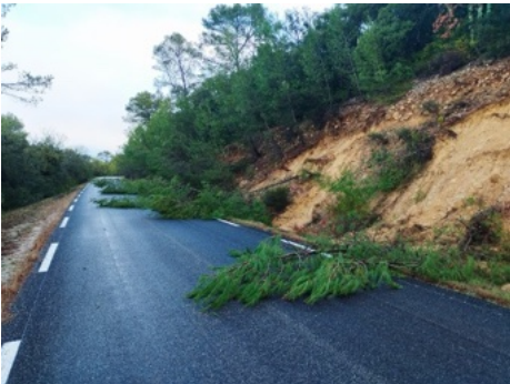
Dégâts sur route départementale D218
