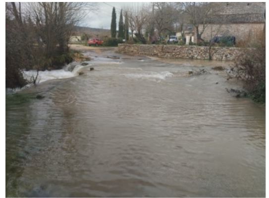
Pont Ancienne Eglise inondé pendant la tempête Monica. La réfection du pont aura lieu au printemps.
